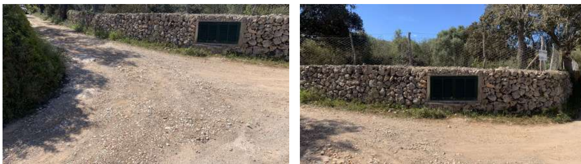
Foto 7 i Foto 8. Armari de comptadors entrada del camí de Sa Rota
