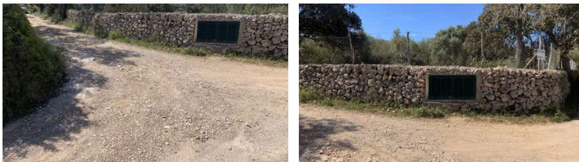
Foto 1 i Foto 2. Armari de comptadors entrada del camí de Sa Rota
