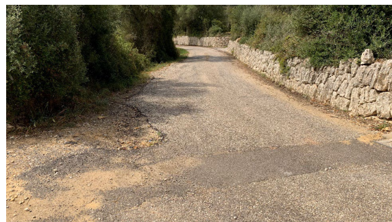
Foto 2. Deteriorament de la calçada
